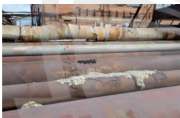
(a) Đường ống làm bằng kim loại bị gỉ
